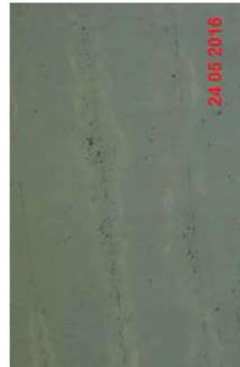
Foto 7. Fissura na viga longitudinal.
