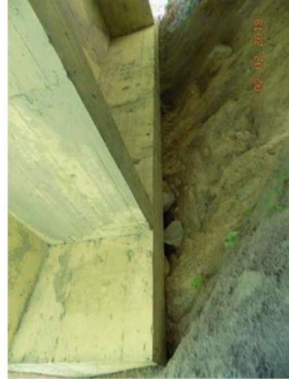
Foto 8. Perda do material sob a cortina.
