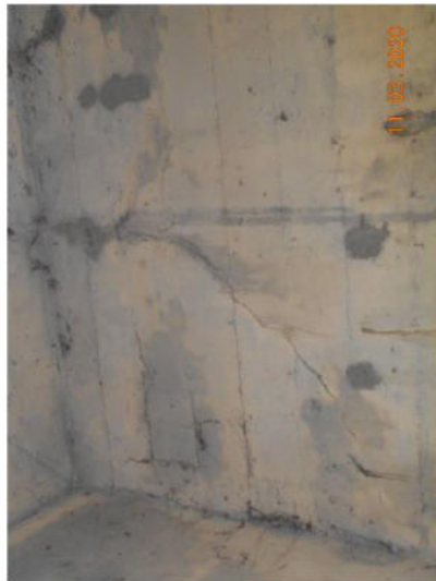
Foto 5. Fissura na viga longarina.
