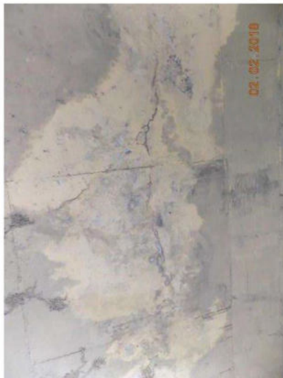
Foto 5. Fissura na laje.
