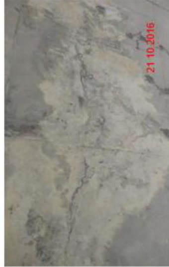
Foto 6. Fissura com eflorescência na laje.
