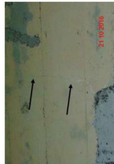
Foto 7. Fissura na viga longitudinal.
