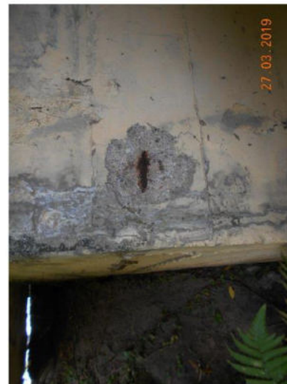
Foto 7. Concreto disgregado com armadura exposta e corroída na cortina.
