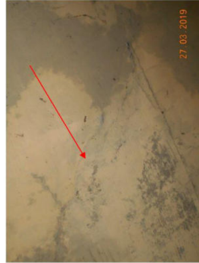
Foto 4. Fissura na laje em balanço.
