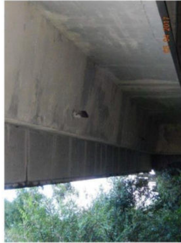
Foto 4. Vista inferior do buzinode de drenagem da pista.
