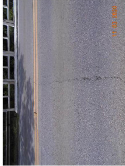
Foto 8. Vista da junta de encontro recoberta por capa asfáltica com sinais de ruptura.
