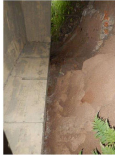
Foto 8. Perda do material sob a cortina.
