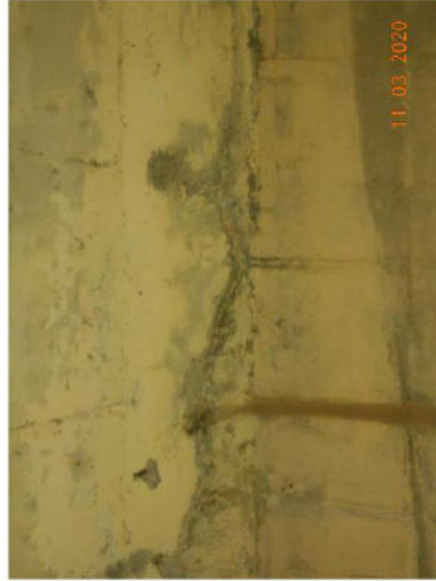
Foto 4. Fissura na laje.
