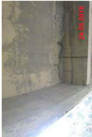
Foto 5. Fissura com efflorescência na laje, próximo a viga transversina.
