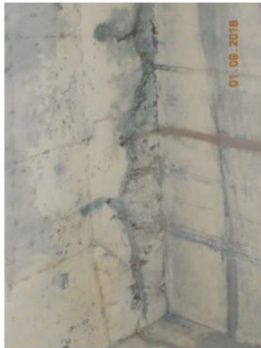
Foto 5. Fissura na laje.
