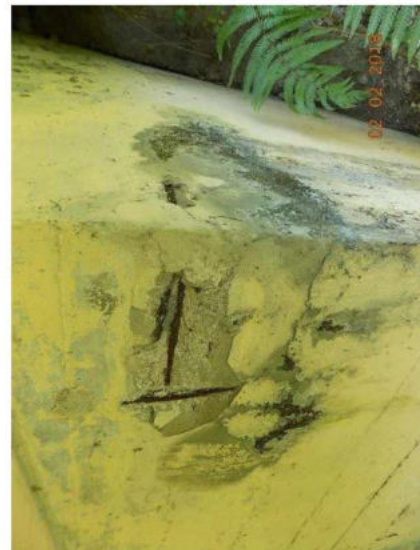
Foto 7. Concreto disgregado com armadura exposta e corroída na cortina.
