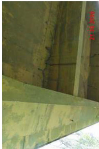
Foto 5. Fissura com eflorescência na laje, próximo a viga transversina.
