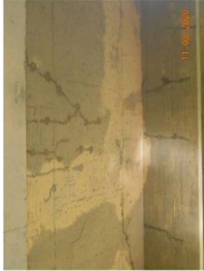
Foto 6. Fissuras tratadas em bom estado na laje e viga longarina.
