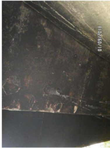
Foto 6. Mancha de fuligem e lascamento do concreto, localizado, na laje em balanço.
