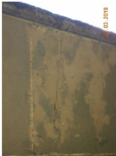
Foto 5. Fissura na laje em balanço.
