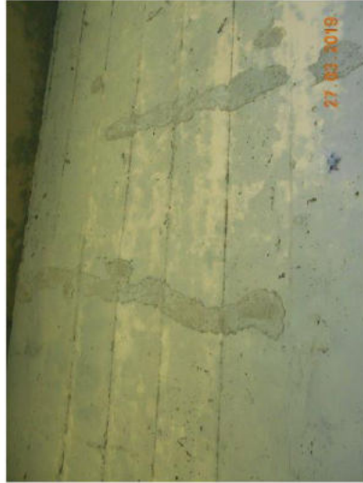
Foto 6. Fissuras tratadas em bom estado na viga longarina.
