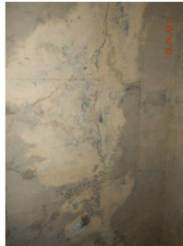
Foto 7. Fissura na laje.
